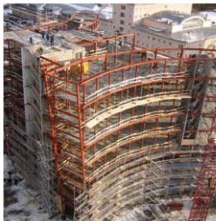
Mjärdevi Centrum in aanbouw. Voor de draagconstructie een warmgewalste staalskelet en voor de buitengevels koudgewalste profielen.
